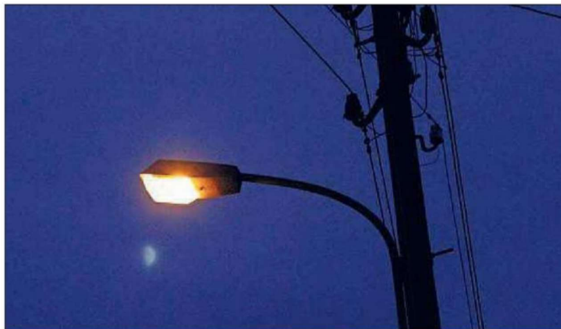
À Moutier, l'éclairage public occasionne une dépense annuelle d'environ 100 000 fr. La facture devrait s'alléger au cours des années à venir.
